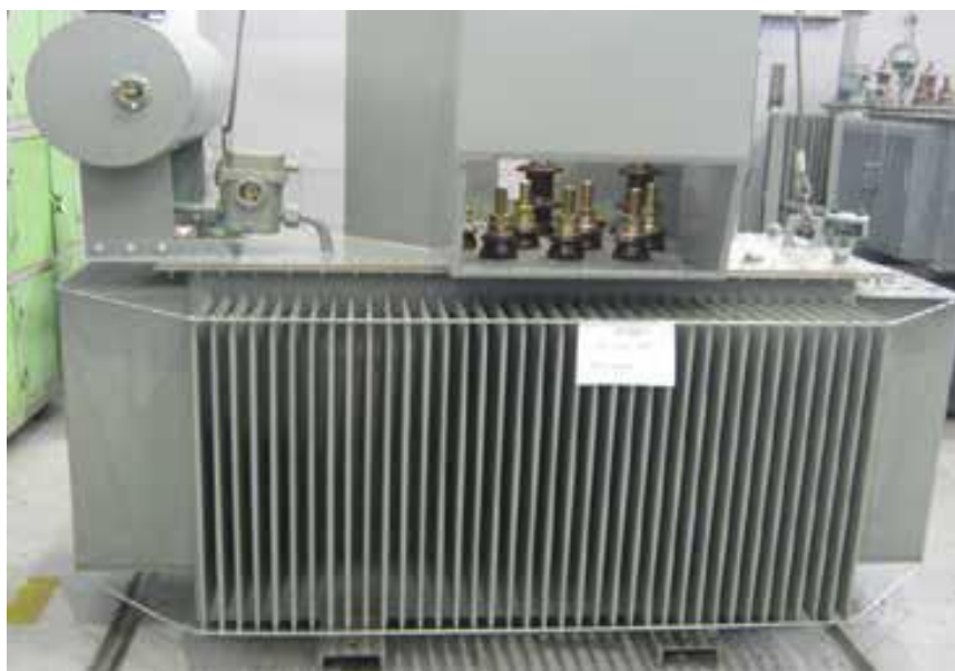
Slika 3.1.2. Izgled transformatora 10/0,4 kV, 630 KVA
