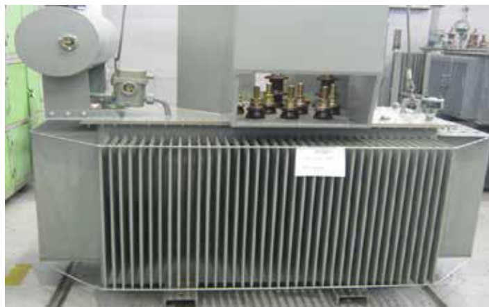
Slika 3.1.2. Izgled transformatora 10/0,4 kV, 630 KVA
